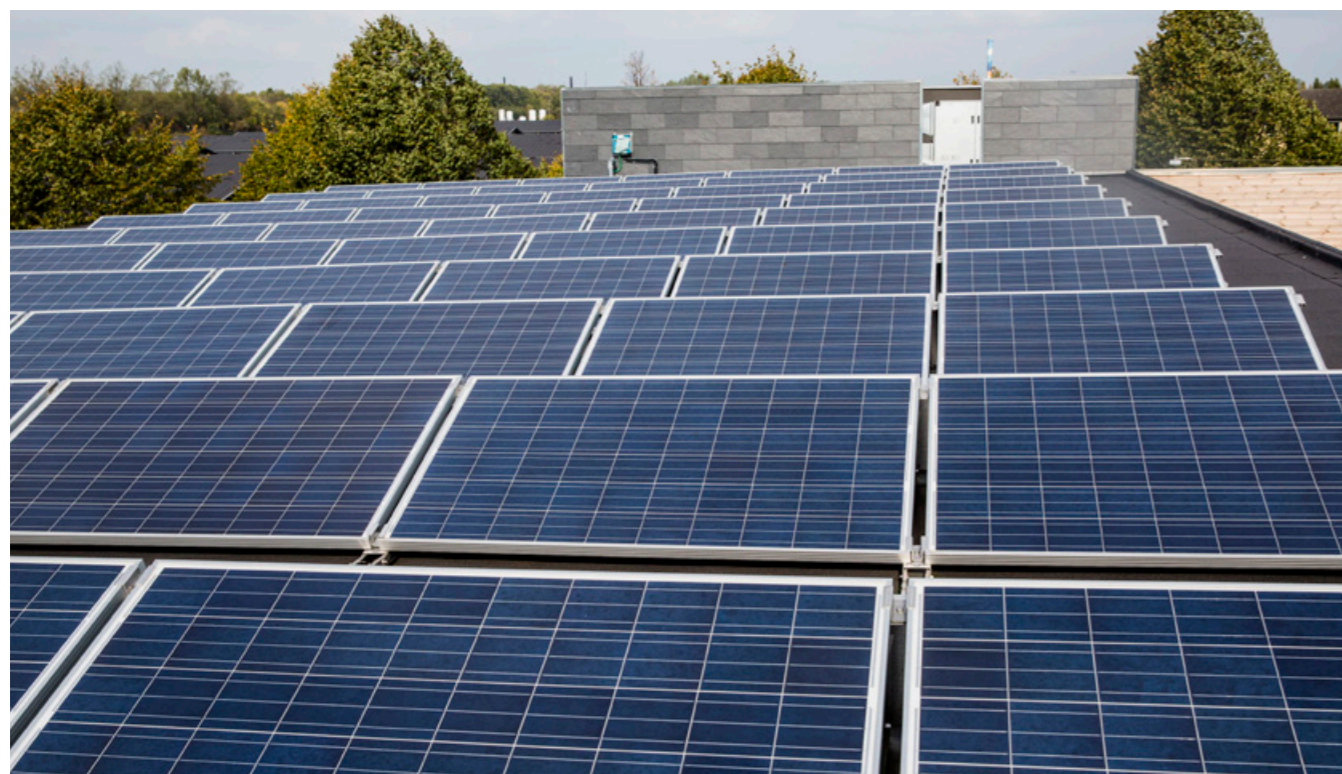
Der er de seneste år opsat mere end cirka 1 MW solceller på de kommunale bygninger. På billedet ses solceller på Birkehøj Plejecenter.
