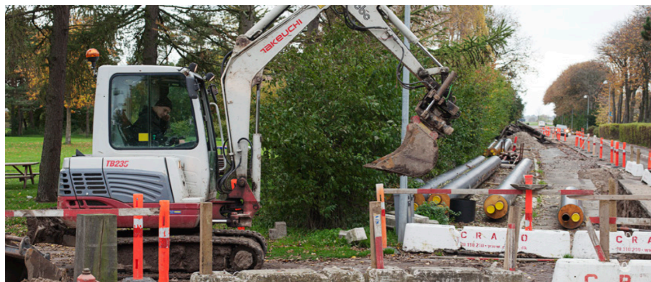
Høje Taastrup Fjernvarme har i løbet af 2014 etableret et lokalt fjernvarmenet i den vestlige del af Fløng. Fløng Skole, Fløng svømmehal og Engvadgaard bebyggelsen varmes nu op med miljørigtig fjernvarme.
