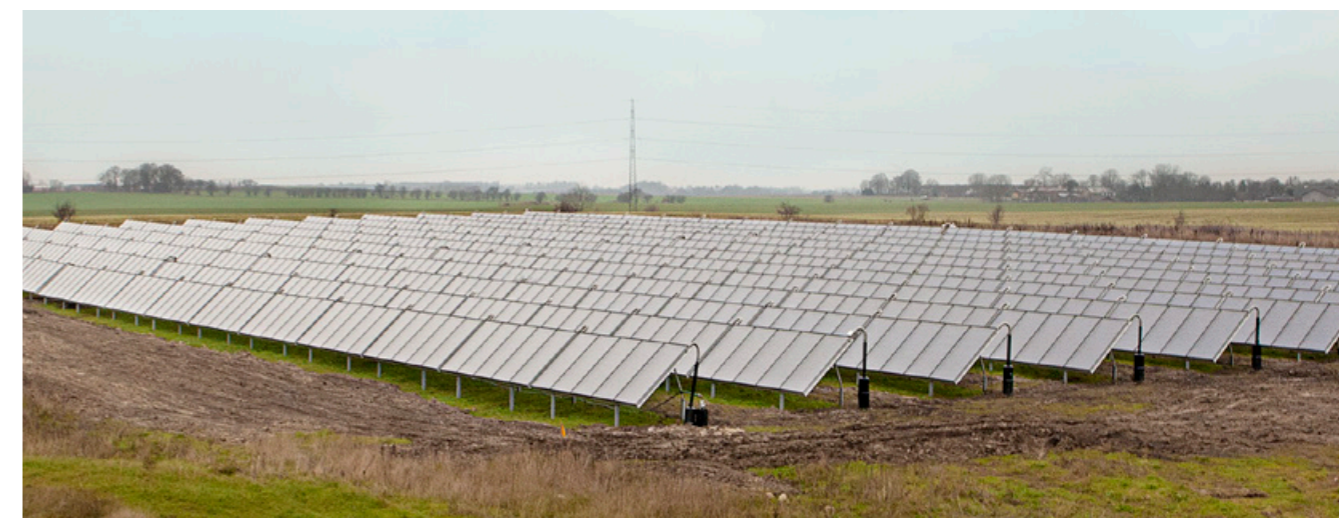
3.000 m 2 solvarmeanlæg i Fløng er sat i drift af Høje Taastrup Fjernvarme i 2014.
